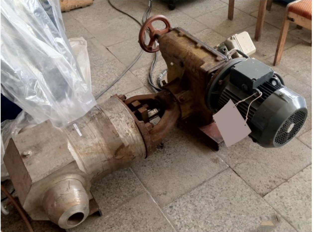
Рисунок Б.3 – Фотография запорной арматуры с электроприводом
